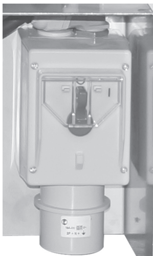
Stromanschluss am Hauptschalter (400 V / 16 A)
