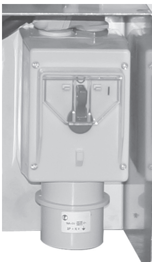
Stromanschluss am Hauptschalter (400 V / 16 A)
