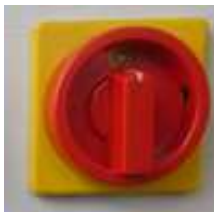
Abb. 71: Hauptschalter auf Stellung „0“
